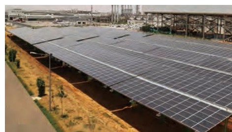
太陽光発電施設
